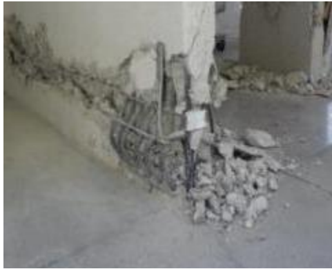
شکل ۱- خردشدگی بتن و کمانش آرماتورهای این ناحیه [۱]
